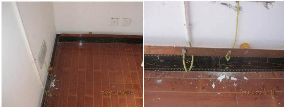
图 5.3.12 室内防雷接地线路布设现状图
