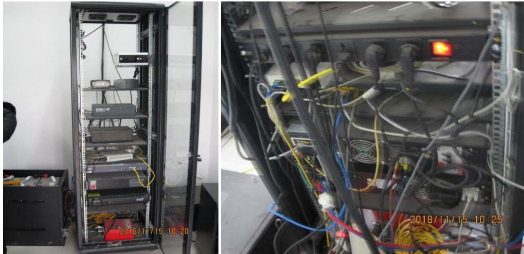
图 5.1.15 镇巴地震观测站设备机柜配置现状图
