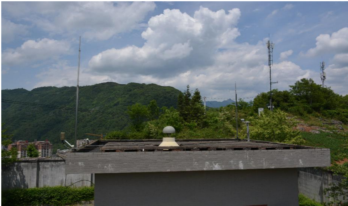
图 5.1.7 镇巴地震观测站避雷针避雷网现状图
