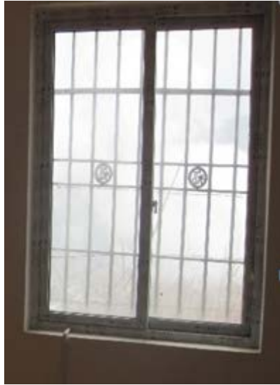
图 5.3.8 略阳（新）GNSS 观测站窗户现状
