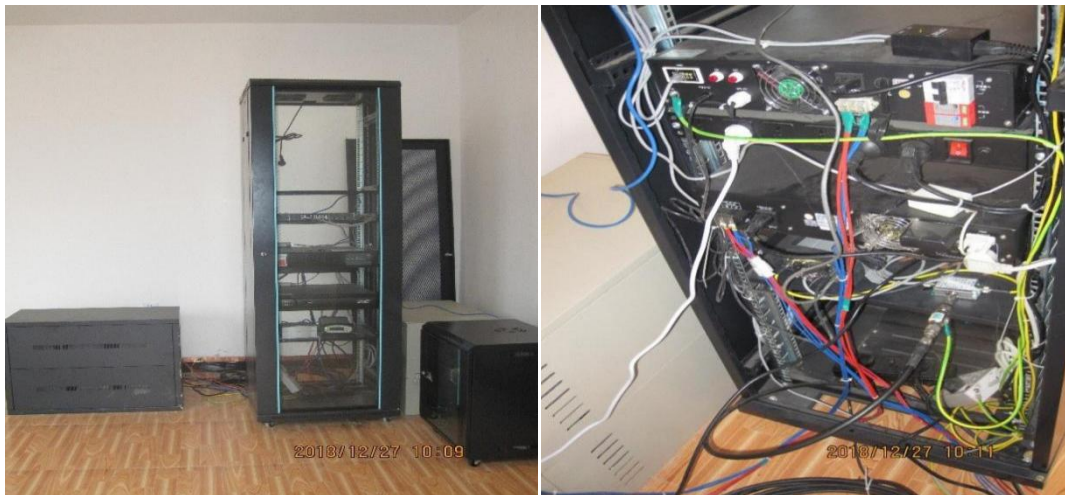
图 5.3.15 略阳（新）GNSS 观测站设备机柜配置现状图
