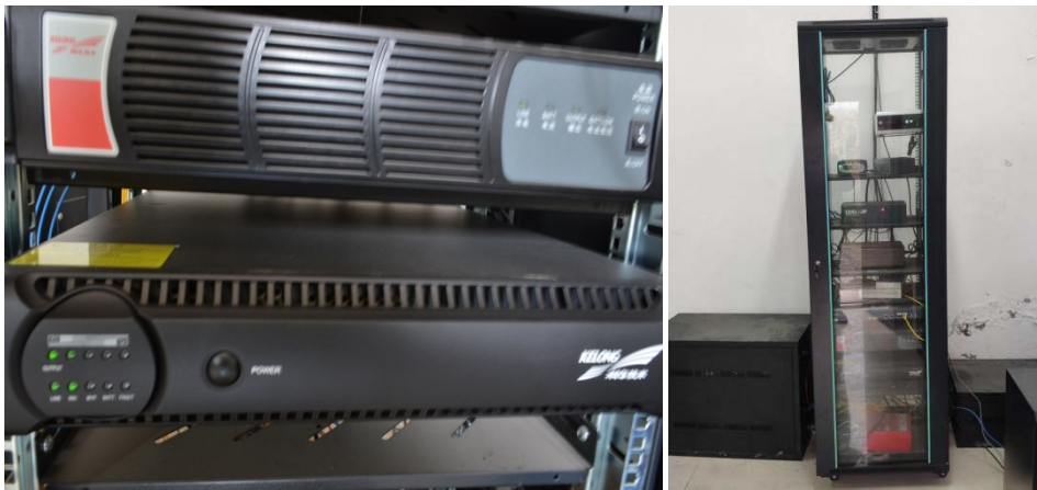
图 5.1.10 室内 UPS 及电池柜现状图
