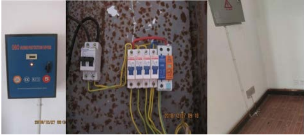
图 5.4.8 室内防雷箱及配电箱现状图
