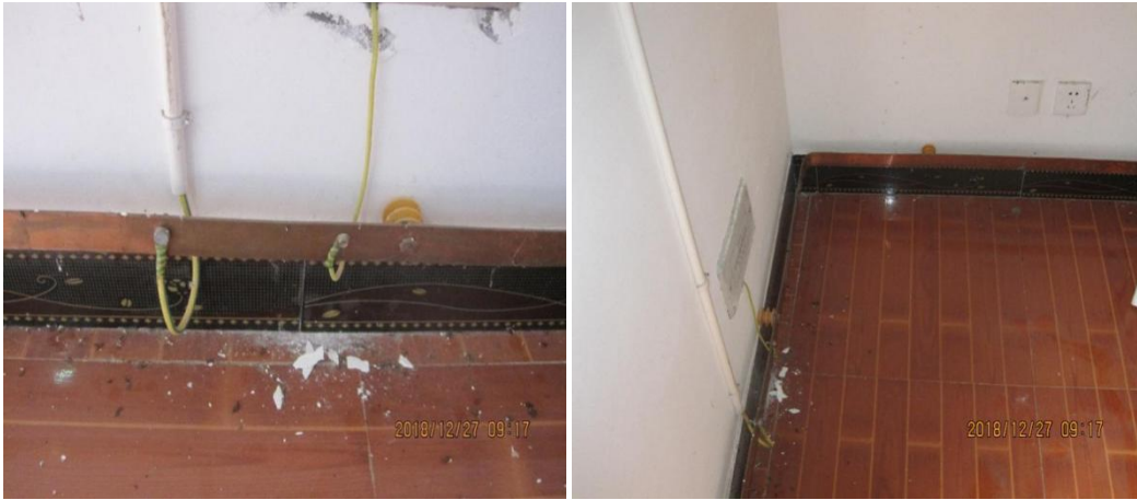
图 5.4.11 室内防雷接地线路布设现状图
