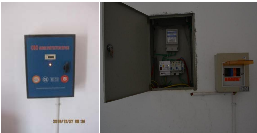
图 5.1.9 室内防雷箱及配电箱现状图
