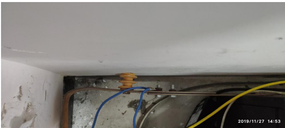
图 5.1.12 室内防雷接地线路布设现状图
