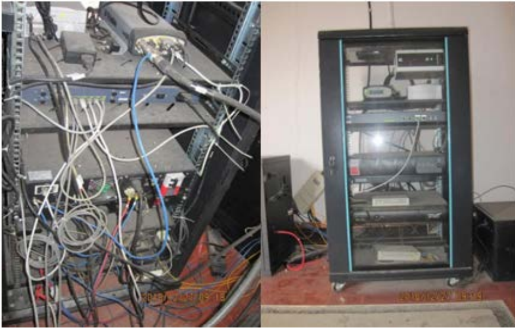
图 5.4.14 略阳（旧）GNSS 观测站设备机柜配置现状图
