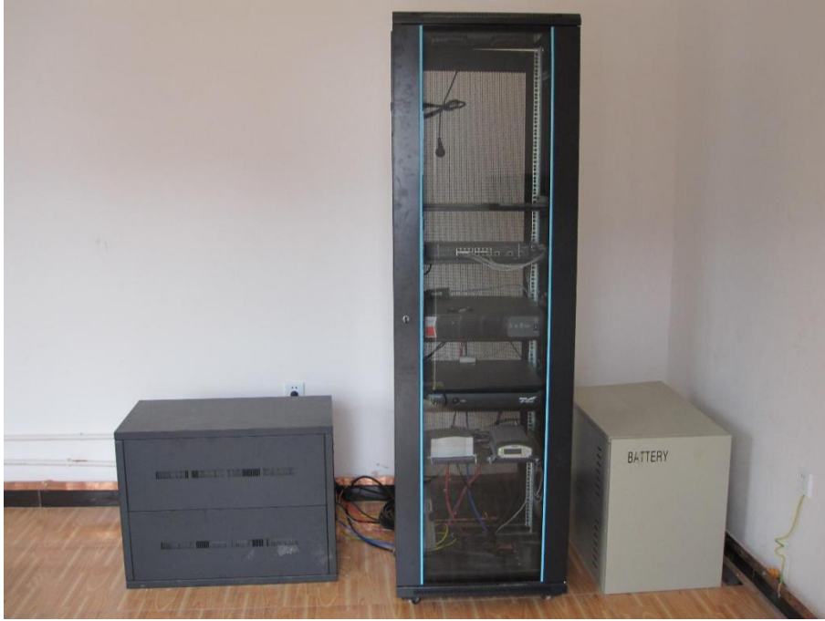
图 5.3.10 UPS 及电池柜现状图
