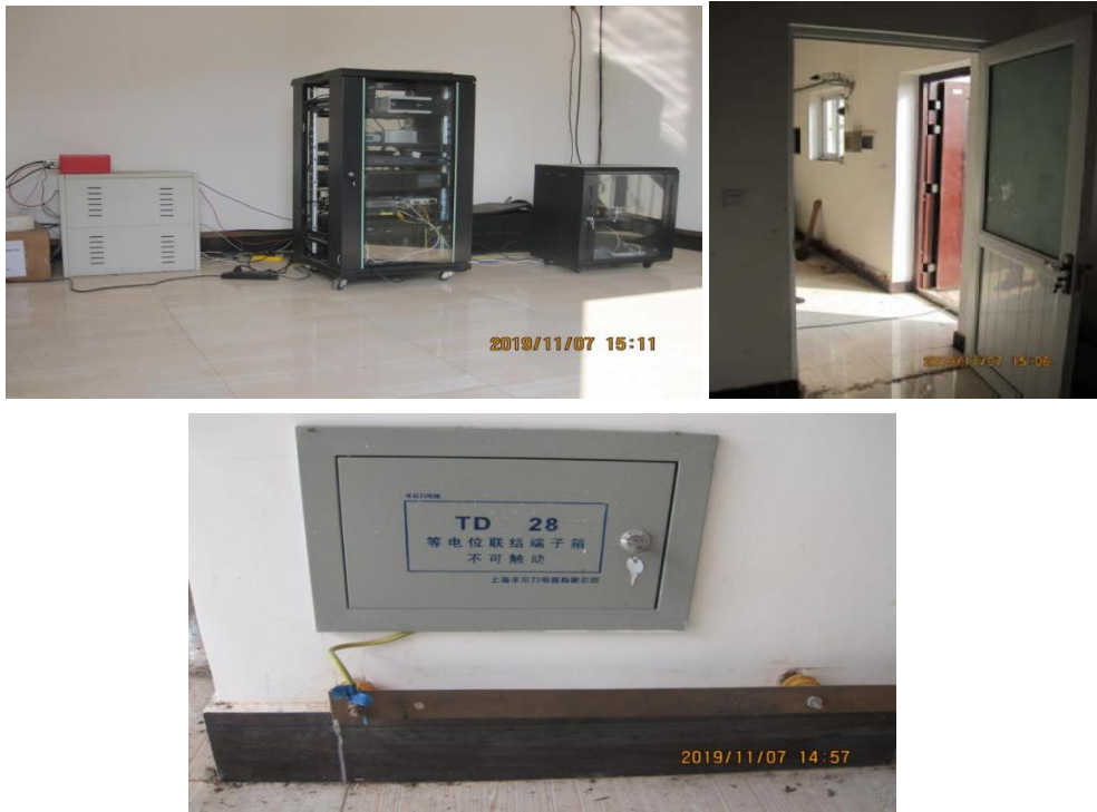
图 5.2.4 勉县 GNSS 观测站配电、防雷、机柜配置现状
