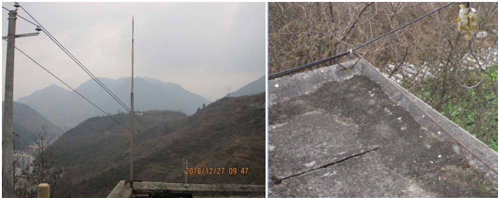
图 5.4.6 略阳（旧）GNSS 观测站避雷针及房顶避雷网现状图
