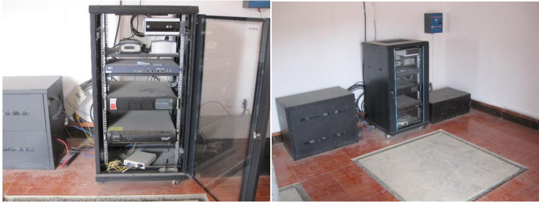
图 5.4.9 室内 UPS 及电池柜现状图
